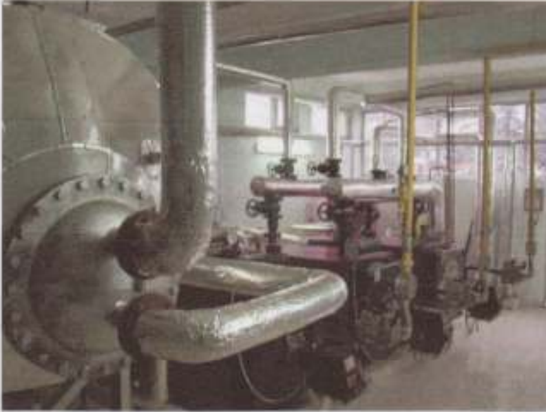
Kazan Dairesinden Genel Görünüm
